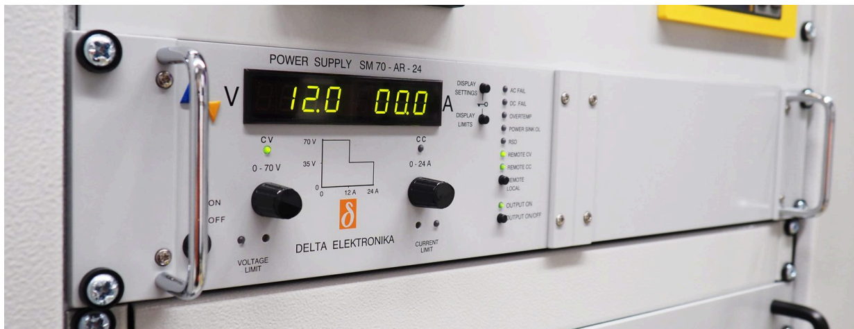
HV-Stromversorgung im IAV Auros Iso. Der DC-Anteil kommt aus dem Netzteil, der AC-Anteil aus dem Ripple Generator.
